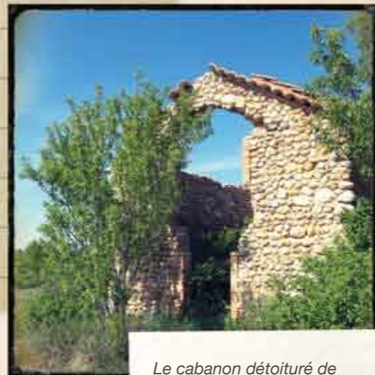
Le cabanon détoituré de Saint-Suffret, Riez
