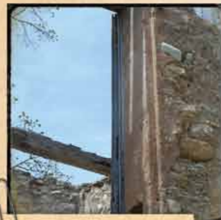
Une feuillure maçonnée directement dans l'enduit.
